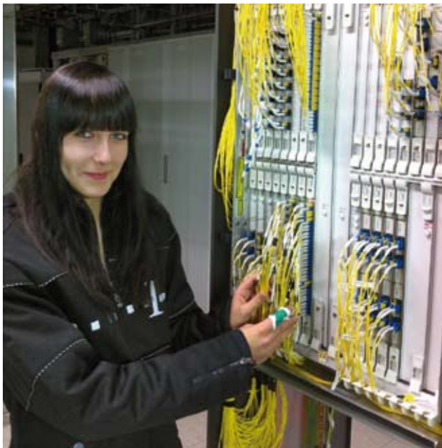
Hauptverteilerprüfung der Glasfaserkabel auf Durchlässigkeit
